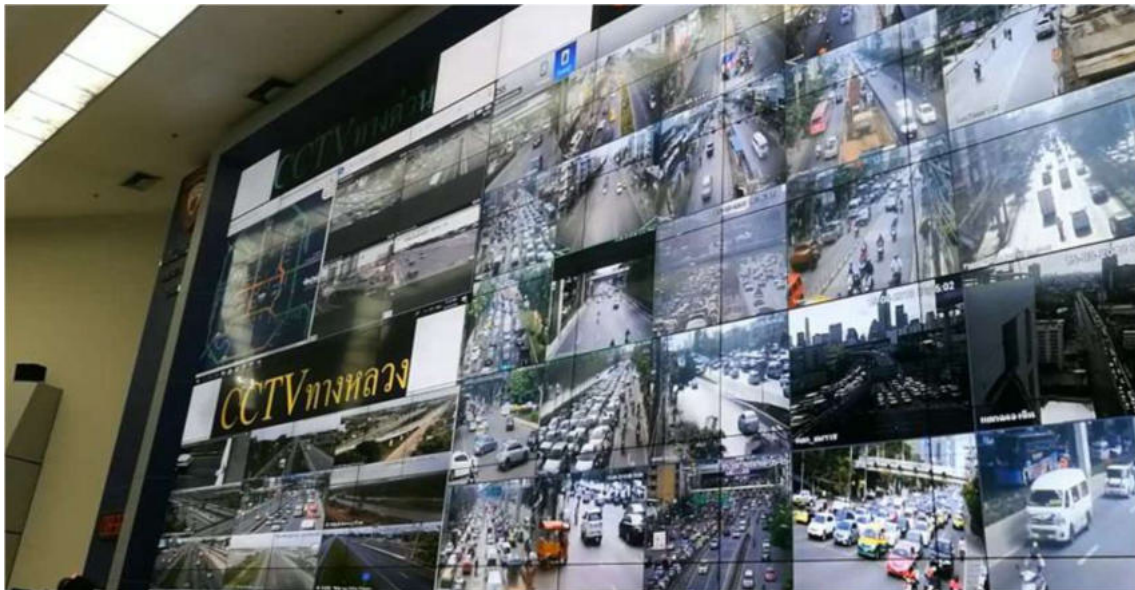
รูปที่ 3.2-11 ศูนย์ควบคุมสั่งการและแก้ไขปัญหาการจราจร กองบังคับการตำรวจจราจร (บก.จร.)
