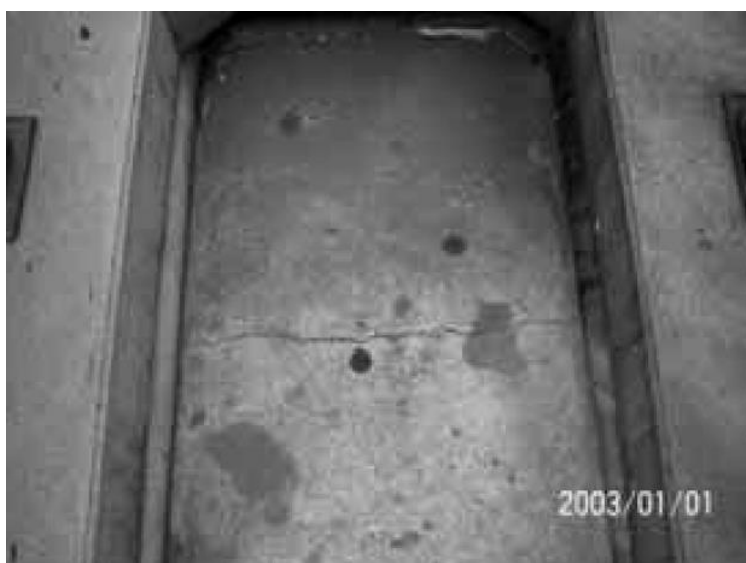
รูปที่ 3-18 รอยร้าวบริเวณพื้นคอนกรีตส่วนล่างรองรับพื้นคอนกรีตรองรับทางวิ่ง (Slab Track)
