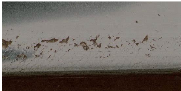
รูปที่ 3-6 เนื้อหลุดร่อนและแตกเป็นเส้นที่หัวราง (Flaking with Head Checking)
