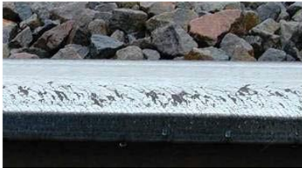
รูปที่ 3-5 การแตกเป็นเส้นที่หัวราง (Head Checking with Spalling)
