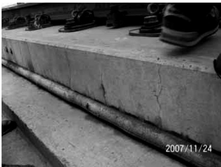
รูปที่ 3-17 รอยร้าวบริเวณพื้นคอนกรีตรองรับรางรถไฟ (Slab Track)
