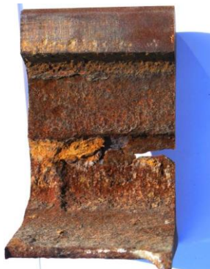
รูปที่ 3-9 การเกิดสนิมในบริเวณเอวรางและฐานราง
