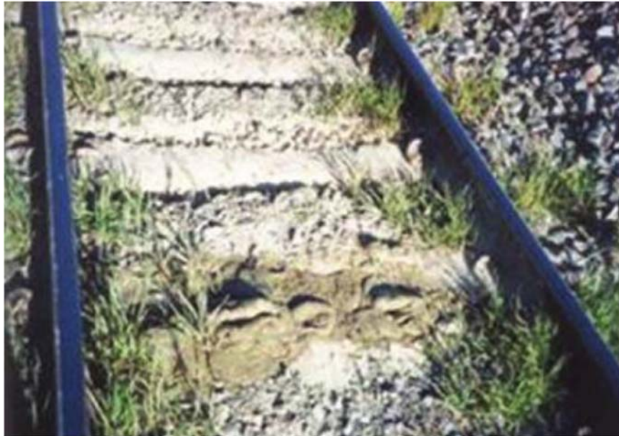
รูปที่ 5-31 ชั้นหินโรยทางที่หลุดตันจากดินเหลวที่อัดตัวขึ้นมาบนเบ้าอนเกิดจากทางที่ไม่มีชั้นรองหินโรยทางหรือชั้นรองหินโรย ทางก่อสร้างไม่ได้มาตรฐาน
