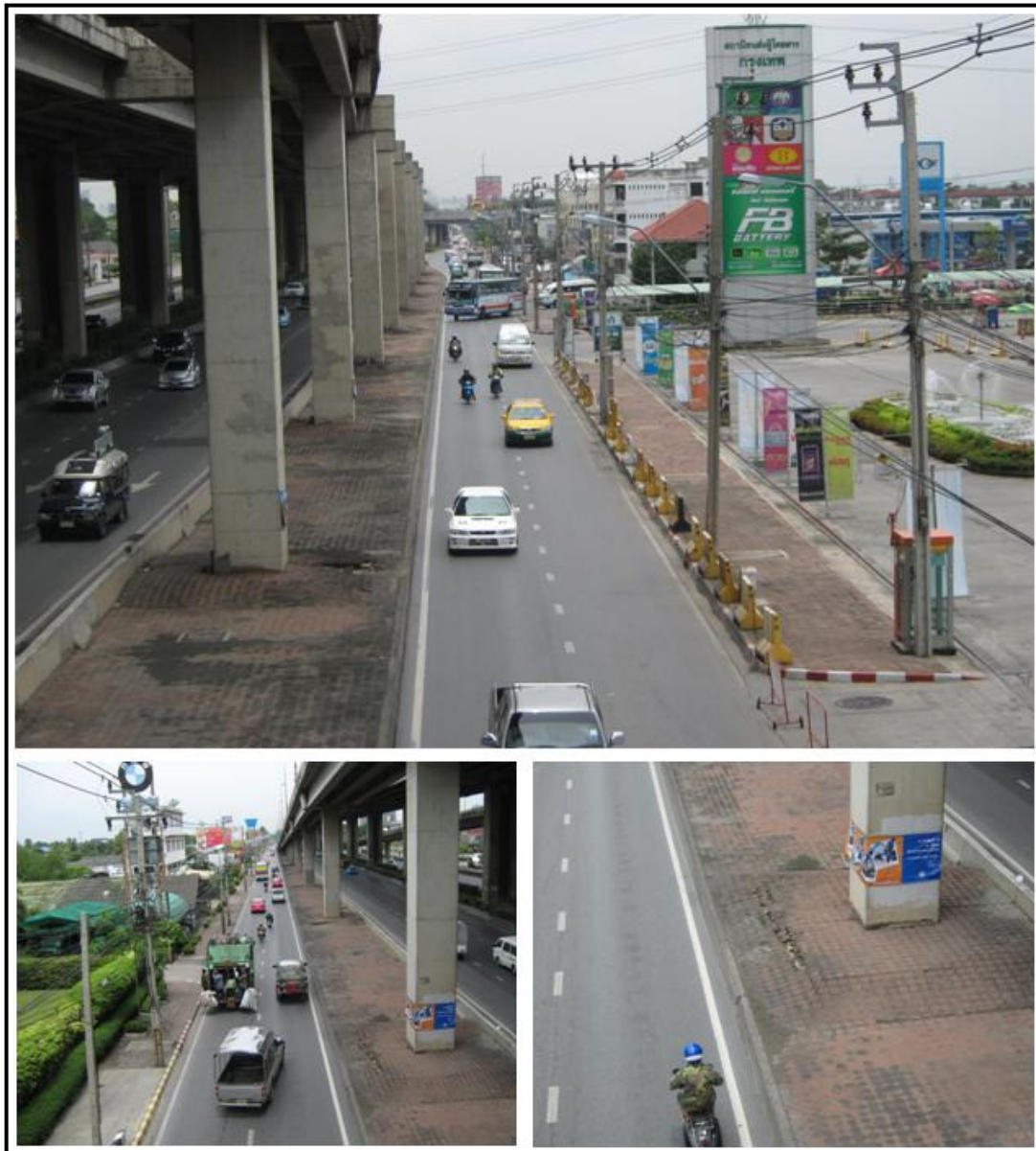
รูปที่ 2.3-24: สภาพทางเท้าชำรุดรอบดอม่อบนเกาะกลางถนนบรมราชชนนี
