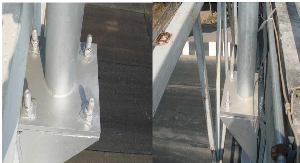
รูปที่ 7.2-1 ตัวอย่างการติดตั้งเสากล้อง CCTV บนสะพานลอยคนข้ามถนน
