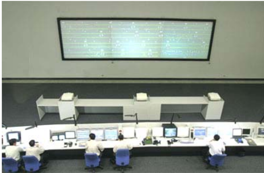
รูปที่ 2.9-1 ศูนย์ควบคุมการเดินรถอัตโนมัติ
