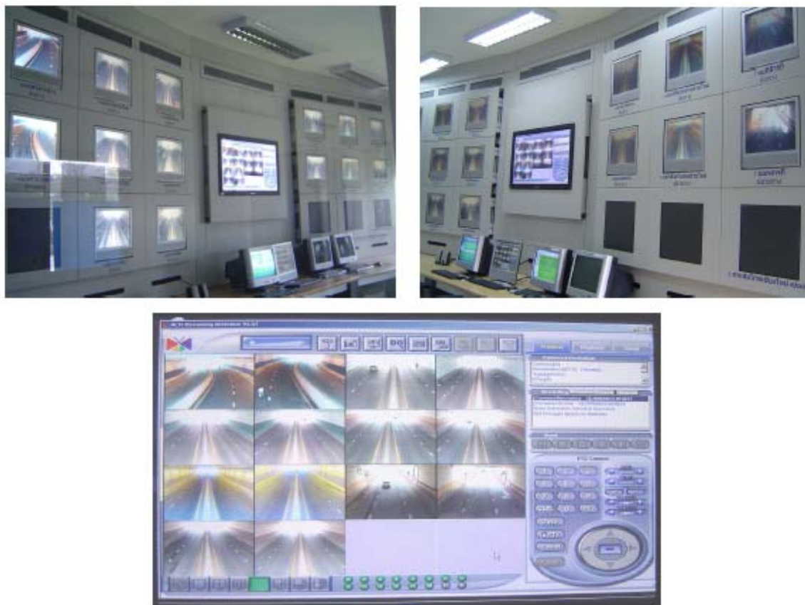
รูปที่ 2.7-2 ระบบสังเกตการณ์บนจอภาพด้วยระบบโทรทัศน์วงจรปิด
