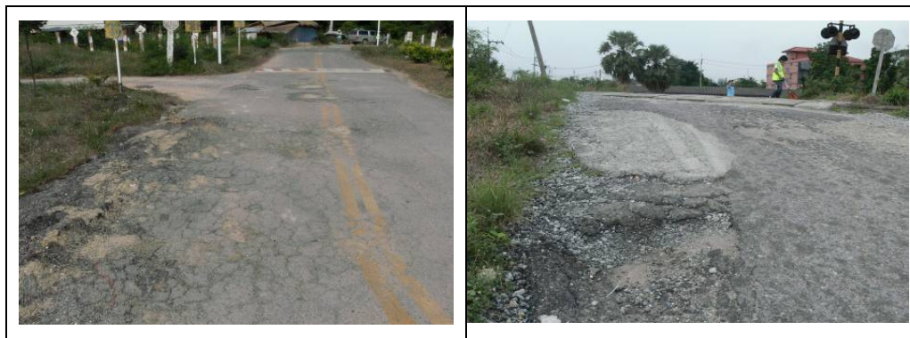
รูปที่ 3.7: แสดงปัญหาสภาพผิวจราจรที่จุดตัดทางรถไฟชำรุด
