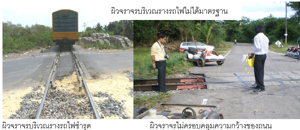
รูปที่ 2.4-9: ปัญหาผิวจราจรบริเวณจุดตัดทางรถไฟ
