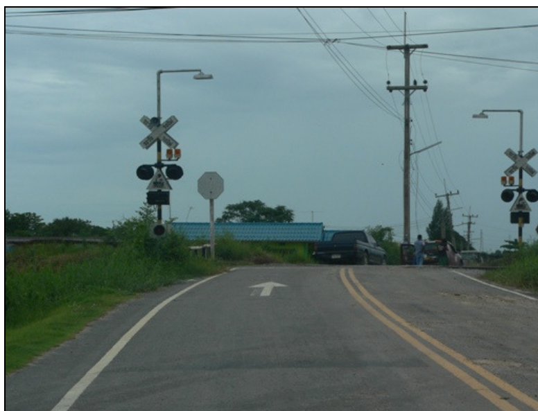
รูปที่ 6.2-10: แสดงสภาพผิวจราจรที่จุดตัดทางรถไฟ
