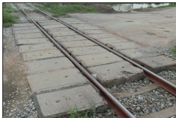
รูปที่ 6.2-6: แสดงสภาพผิวจราจรที่จุดตัดทางรถไฟ
