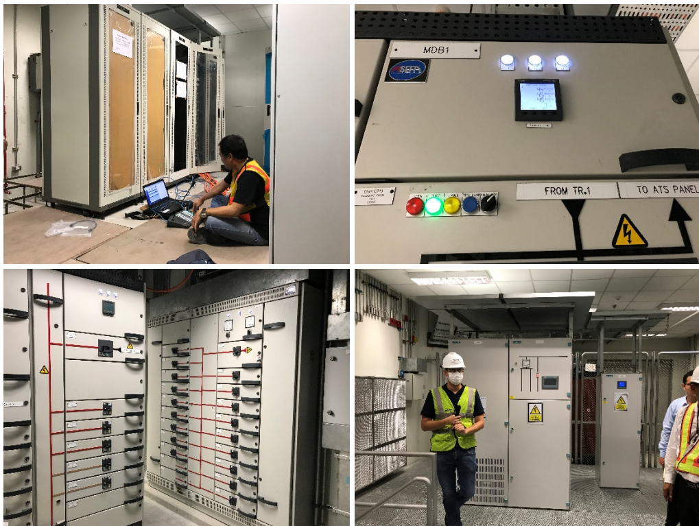
ระบบอาณัติสัญญาณต่างๆ เช่น Traction Sub Station (TSS), Service Sub Station (SSS), UPS, Signal Control ณ สถานีช้างเอราวัณ
