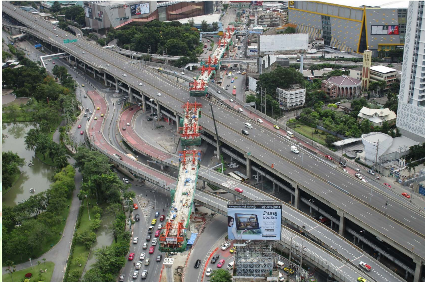
งานก่อสร้าง Balanced Cantilever บริเวณห้าแยกลาดพร้าว
