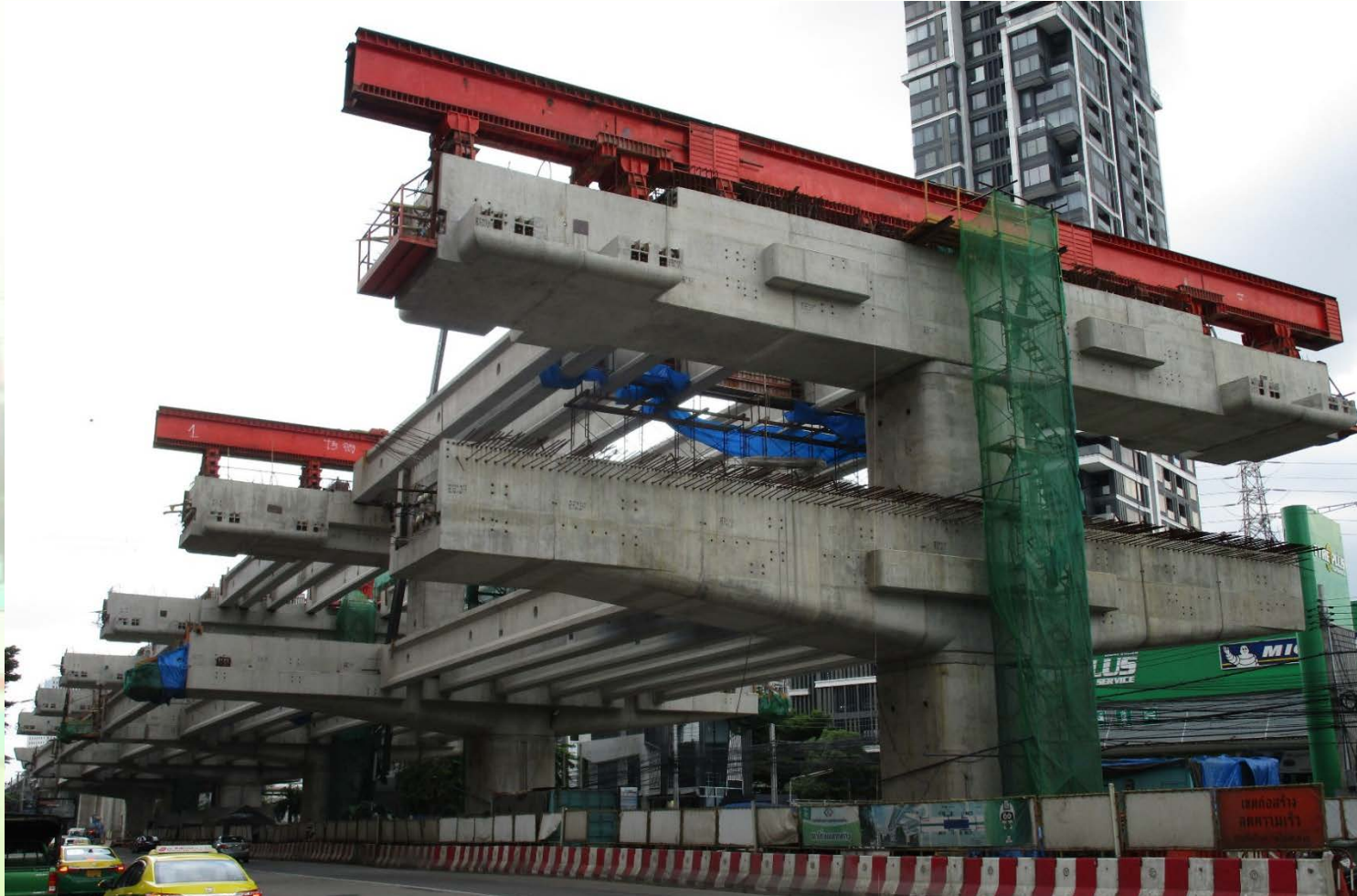
งานก่อสร้างสถานีห้าแยกลาดพร้าว (Station N9)
