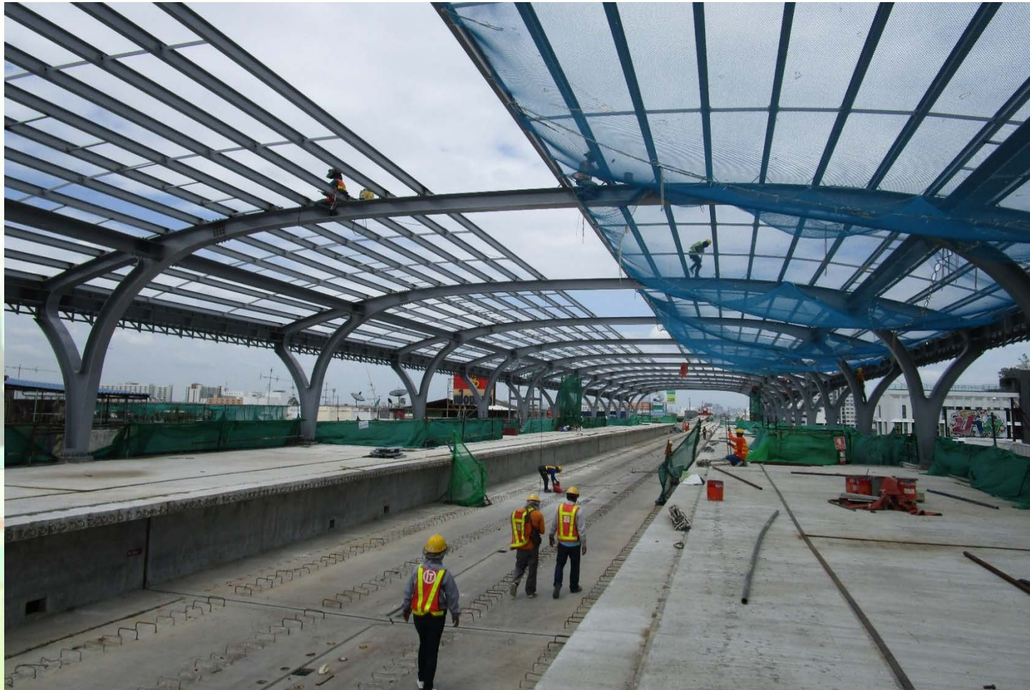
งานก่อสร้างสถานีอนุสาวรีย์หลักสี่ (Station N18)
