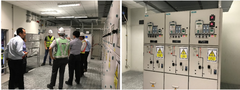
ระบบอาณัติสัญญาณต่างๆ เช่น Traction Sub Station (TSS), Service Sub Station (SSS), UPS, Signal Control ณ สถานีช้างเอราวัณ (ต่อ)
