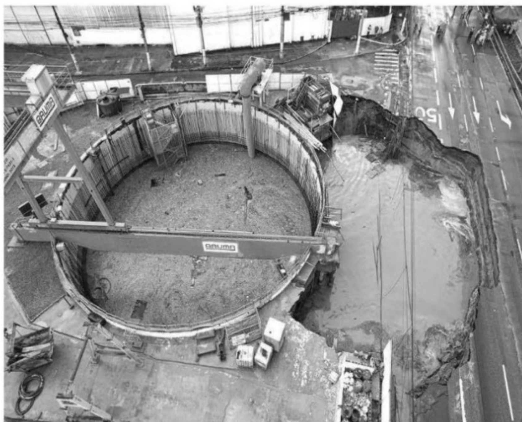
ถนนยุบ - ภาพถ่ายทางอากาศเผยให้เห็นอุบัติเหตุที่ถนนถล่มลงมาเป็นวงกว้างซึ่งอยู่ในบริเวณที่มีการขุดอุโมงค์เพื่อทำรถไฟใต้ดินสายใหม่ ที่เมืองเซา เปาโล ประเทศบราซิล เมื่อวันที่ 1 กุมภาพันธ์ (เอเอฟพี)
