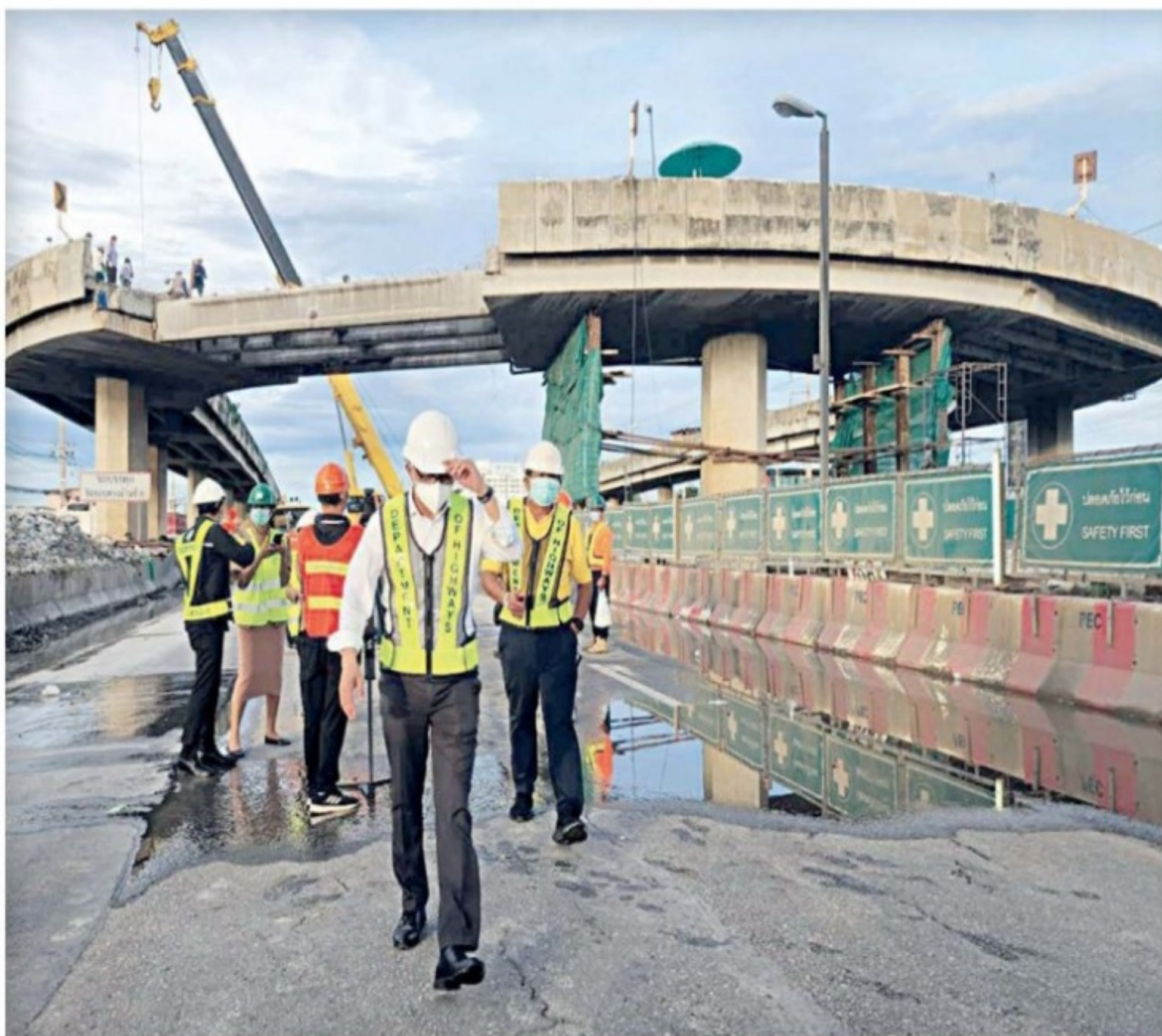
▲ ตรวจสอบ...นายสรารุช ทรงศิริไถ อธิบดีกรมทางหลวง (ทล.) พร้อมคณะเข้าตรวจสอบสถานที่เกิดเหตุคานเกือบกลับรถพังถล่ม ที่ถนนพระราม 2 บริเวณหน้า รพ.วิการาม ขาเข้ากรุงเทพฯ จ.สมุทรสาคร
