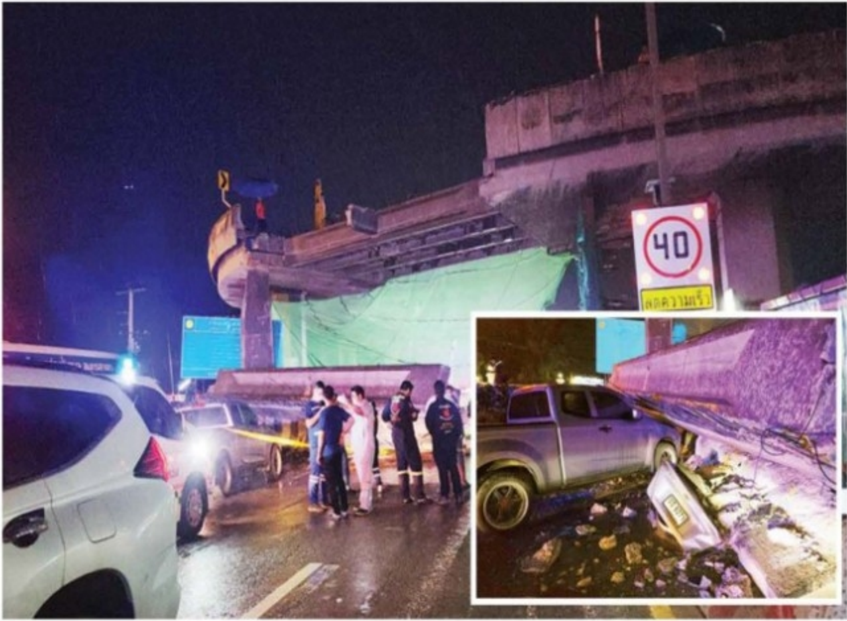
คานถล่ม - คานคอนกรีตขนาดใหญ่ทางกลับรถ ถนนพระราม 2 จ.สมุทรสาครที่กำลังก่อสร้าง พังถล่มทับรถยนต์ที่กำลังวิ่งผ่าน พังเสียหายยับ 2 คัน มีผู้เสียชีวิตติดคาซาก 1 ราย อีกรายสันใจที่โรงพยาบาล เมื่อวันที่ 31 ก.ค.
