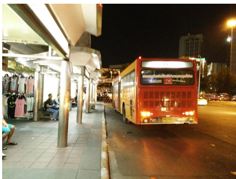
ภาพที่ 142 ไม่มีทางลาดเชื่อมต่อระหว่างพื้นถนนกับทางเท้า
