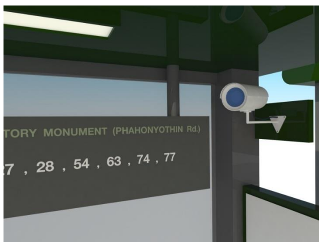
ภาพที่ 134 กล้องวงจรปิดบริเวณป้ายรถโดยสารประจำทางเพื่อความปลอดภัยสำหรับผู้รอใช้บริการ กล้องวงจรปิด
