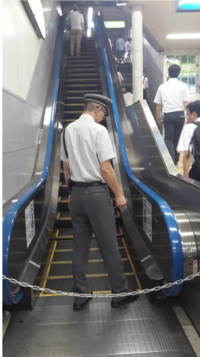
ภาพที่ 14 บันไดเลื่อนแบบปรับใช้กับรถเข็นคนพิการได้ที่สถานีรถไฟ Shimbashi
