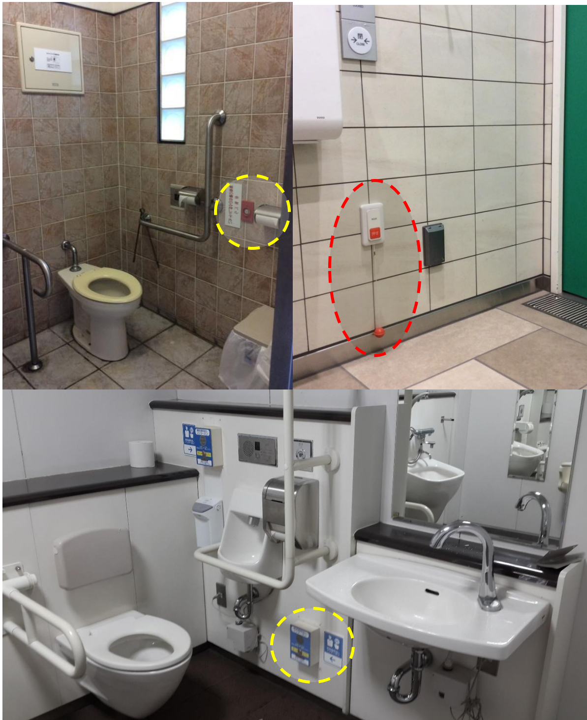
ภาพที่ 57 ให้มีสัญญาณเรียกขอความช่วยเหลือกรณีฉุกเฉินภายในห้องน้ำ ติดตั้งในระดับที่ใช้สะดวกทั้งทำยืน นั่ง หรือนอน (ลิ้ม)
