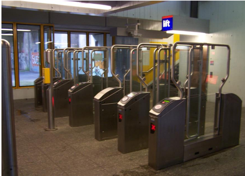
รูปที่ 14 อุปกรณ์กันทางเข้าสถานีรถไฟใต้ดิน Amsterdam Venserpolder Metrostation
