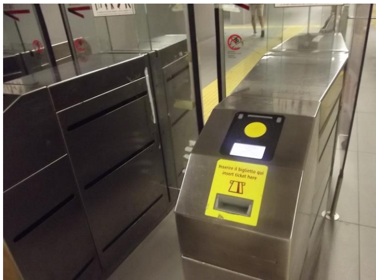
รูปที่ 24 เครื่องกั้นทางเข้าสถานีรถไฟใต้ดินที่สถานี Conca d'Oro
