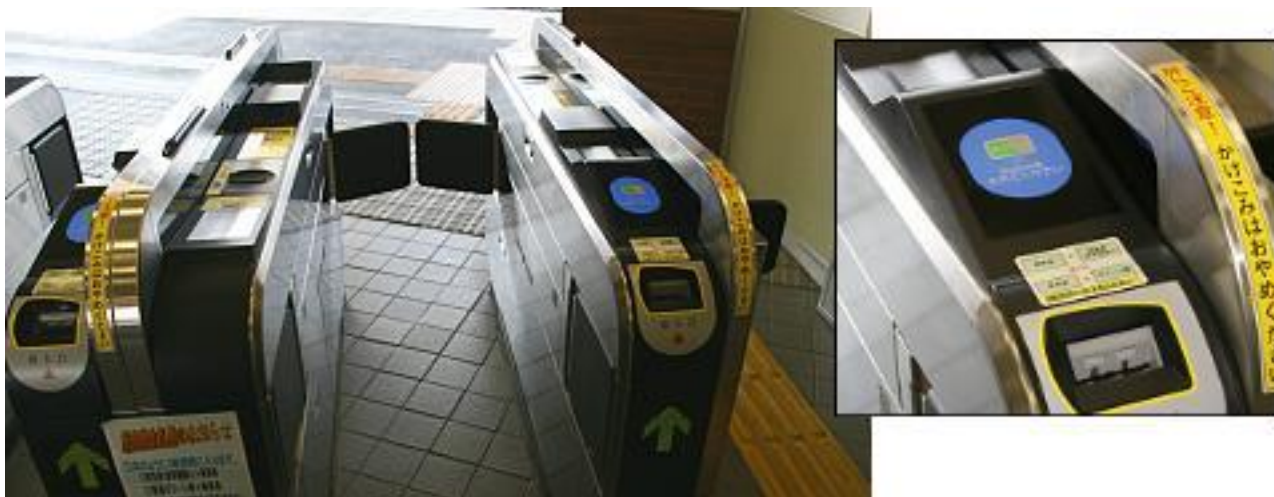
ไม้กั้นที่ติดตั้งเครื่องอ่านบัตร Suica
