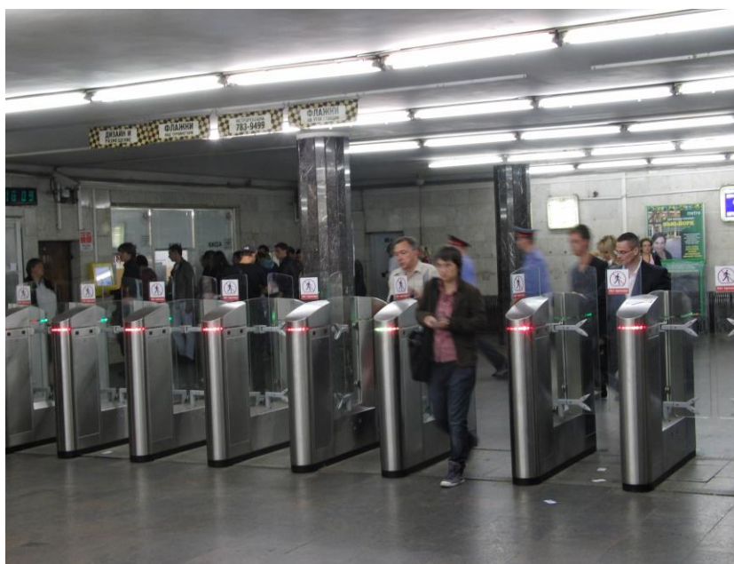
รูปที่ 9 อุปกรณ์กันทางเข้าสถานีรถไฟใต้ดิน Kievskaya
