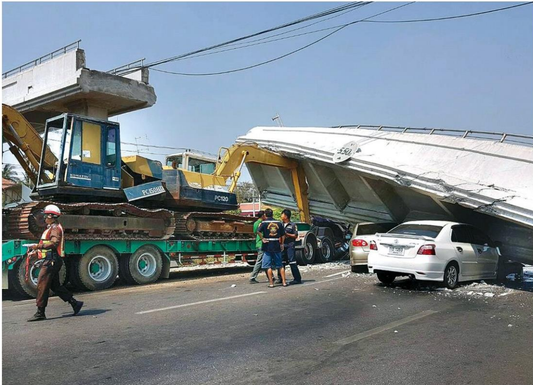
ถล่ม - อุบัติเหตุรถเทรลเลอร์บรรทุกแบ็กโฮ เกี่ยวสะพานลอยข้ามถนนสายเอเชีย หลักก.ม.ที่ 50+700 ต.บ้านอิฐ อ.เมือง จ.อ่างทอง พังลงมาทับรถเก๋ง 2 คัน ส่งผลให้การจราจรติดขัดนานหลายชั่วโมง เมื่อวันที่ 21 ก.พ.
